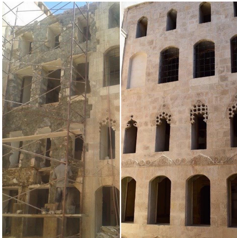
The Greek Catholic Church, archbishopric façade before and after restorations الأضرار وإعادة ترميم واجهة مكتب المطرانية لكنيسة الروم الكاثوليك (16 تشرين الثاني 2018) Joseph Megarbane, Facebook page (November 16, 2018)
